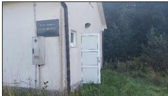
Slika 11. Kaptirani objekt izvora Hajdarevac
